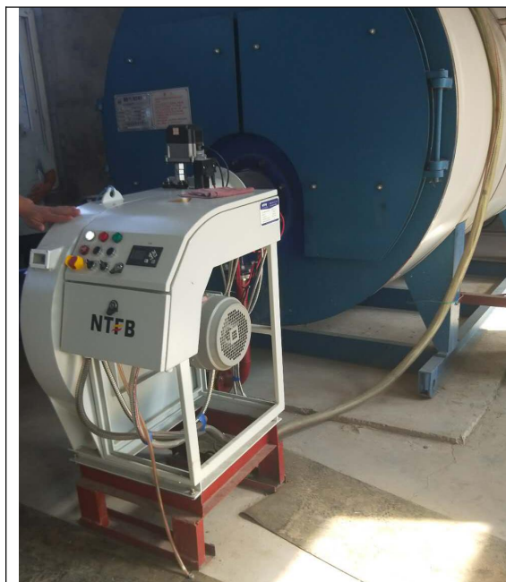
锅炉及低氮燃烧器
